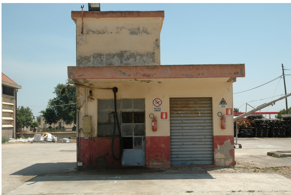
Foto n.6: 4 Cerignola Borgo Tressanti deposito carburanti
